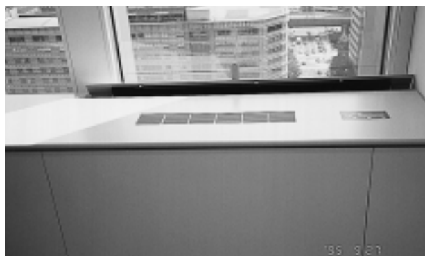
写真 - 3 ウォールスルーエアコン収納ペリカウンター
