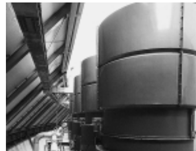
写真 - 6 冷却塔消音器
