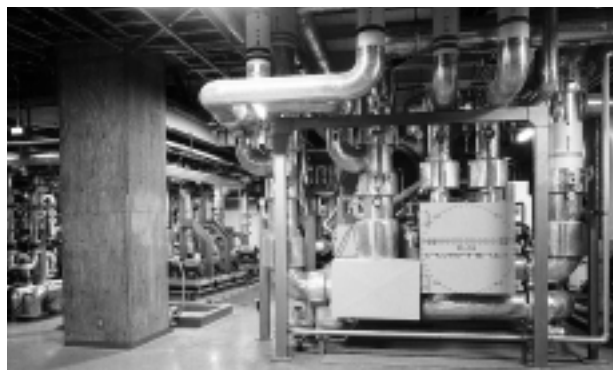
写真 - 4 ヒーティングタワーターボ冷凍機
