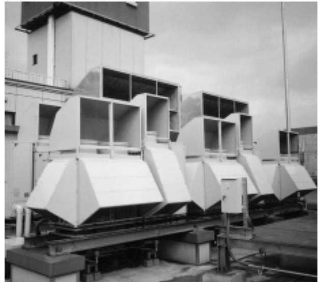
写真 - 3 屋外機外観
