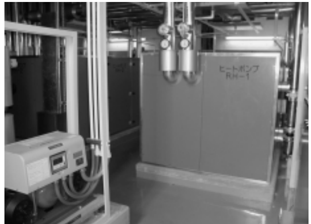
写真 - 3 ヒートポンプ
