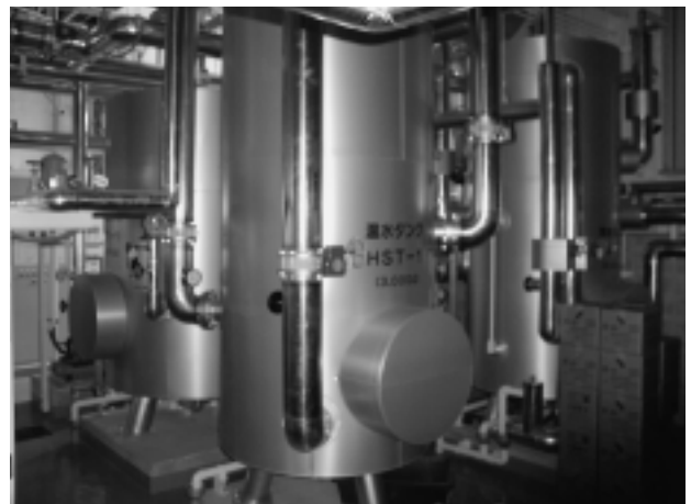
写真 - 4 蓄熱タンク
