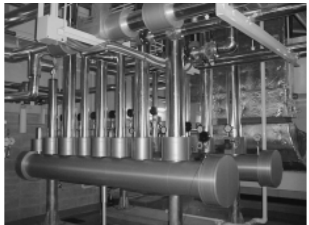
写真 - 5 温水ヘッダー
