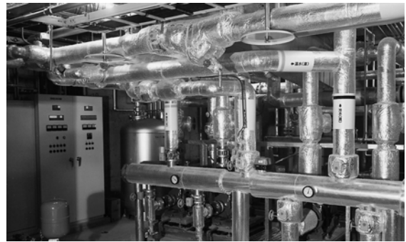
写真 - 2 熱源機械室
