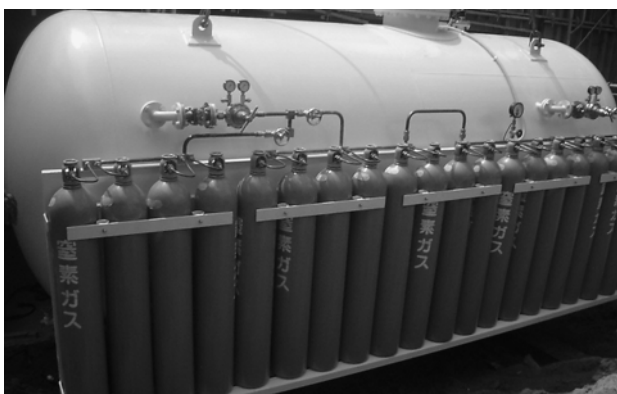
写真 - 6 蓄圧式スプリンクラーシステム
