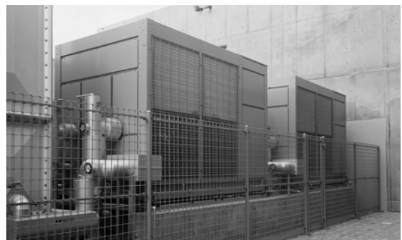
写真 - 4 屋外ユニット
