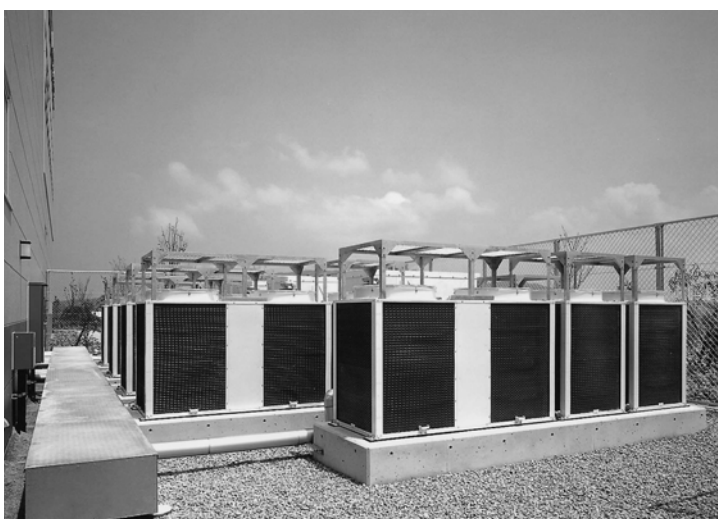
写真 - 3 室外機置場
