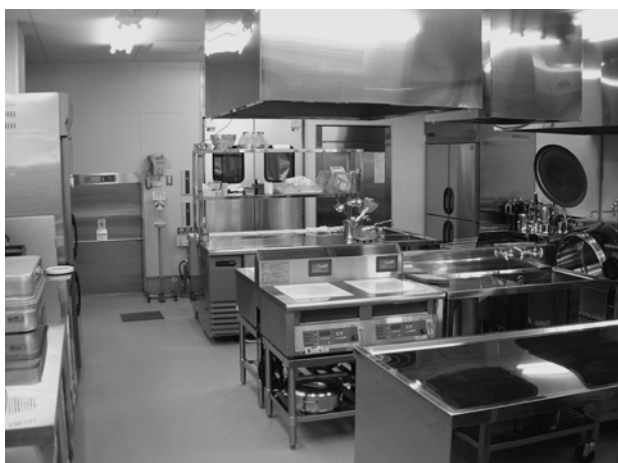
写真 - 5 電化厨房
