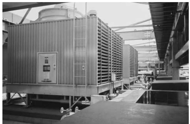
写真 - 3 屋上密閉式冷却塔
