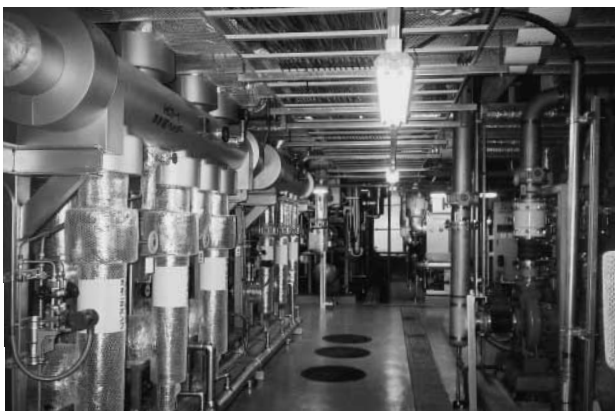
写真 - 2 地下1階機械室
