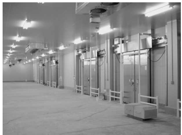
写真 - 3 低温倉庫 大型冷凍庫防熱扉
