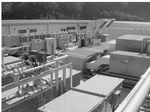
写真 - 2 2階ベランダ 空調・冷却機器置場
