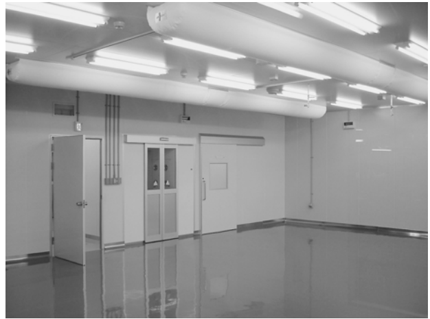
写真-4 食品工場 盛り付け室ソックダクト
