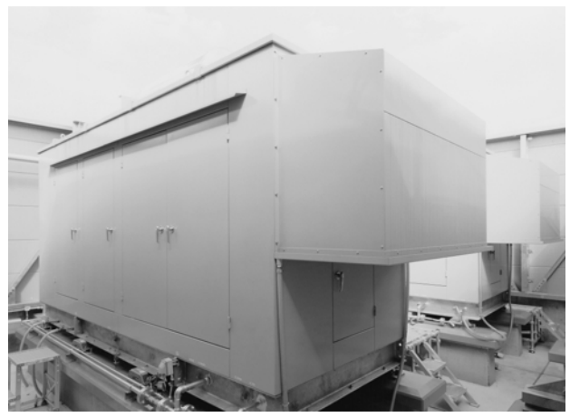
写真 - 6 CGS発電機
