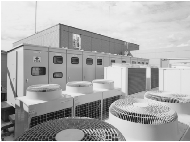
写真 - 5 受変電設備と空調室外機
