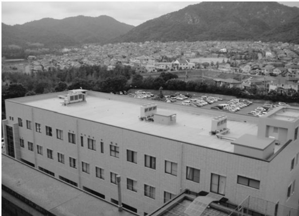
写真 - 2 室外機置場
