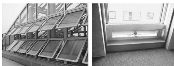
写真 - 5 トップライト換気窓と外気取入口
