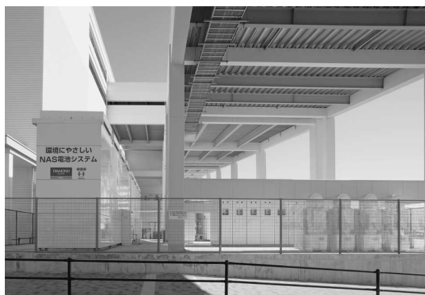
写真 - 11 NAS電池
