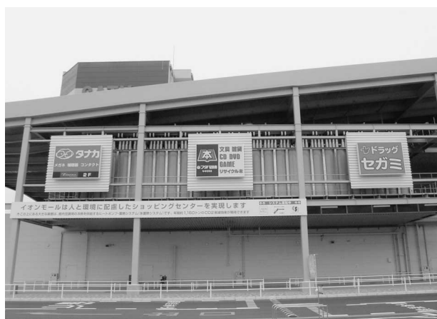
写真 - 6 氷蓄熱槽の下層部はお客様用駐輪場
