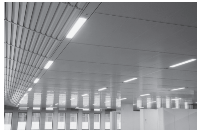
写真-2 ペリメータ放射パネル
