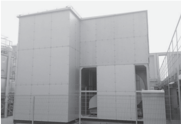
写真-3 デシカント空調機
