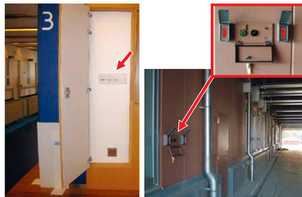
写真-6 災害時用アウトレット
