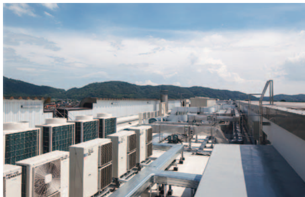
写真-3 屋上設備機器置場
