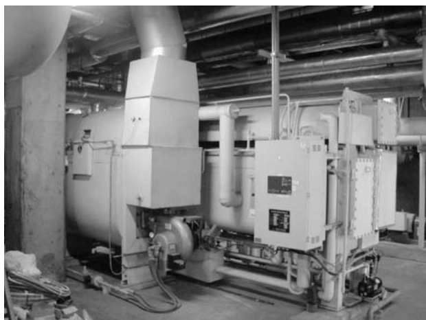
写真-4 既設吸収式冷温水発生機
