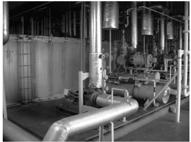
写真-2 既設アイスチラー
