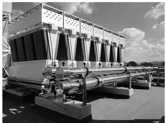
写真-3 空気熱源モジュールチラー
