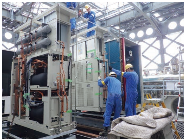
写真-5 機器設置状況
