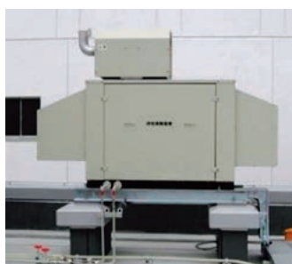
60kVA非常用発電機 (72時間連続運転可)
