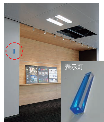
写真-5 自然換気有効表示灯
