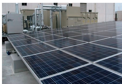
太陽光発電パネル (20kW)
