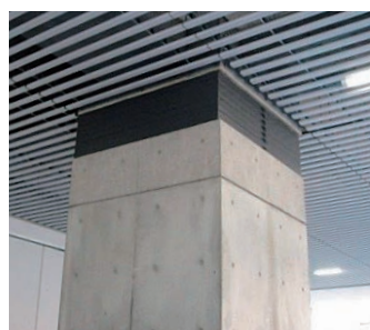
高減衰ゴム免震装置 (黒い部分は耐火被覆カバー)
