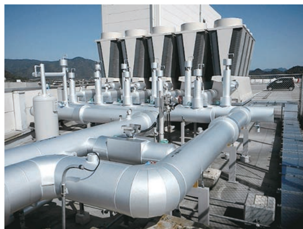
写真-3 改修後空気熱源ヒートポンプチラー
