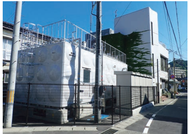
写真-2 集中給湯施設外観
