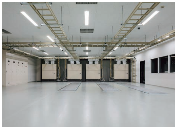
写真-5 空調最重要室・マスターラック室
