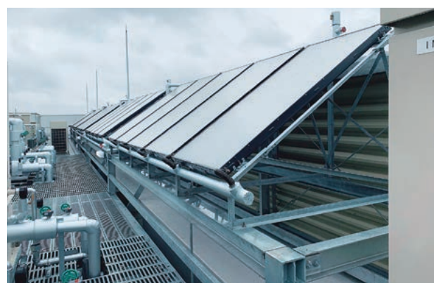
写真-2 太陽熱集熱設備 設置状況
