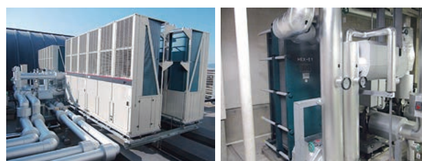
空気熱源ヒートポンプチャラー 「高効率、最適台数制御、故障時バックアップ」 熱融通用の熱交換器 「ピークカットに利用」
