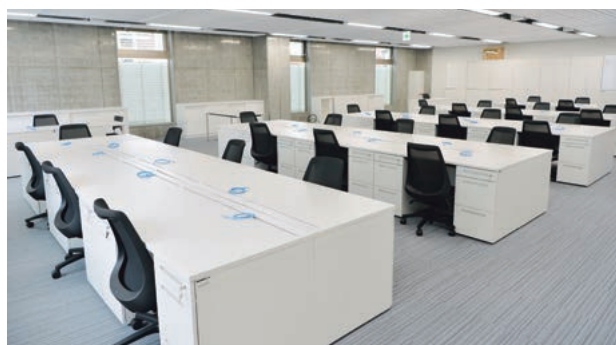
写真-3 事務室(水式天井放射)
