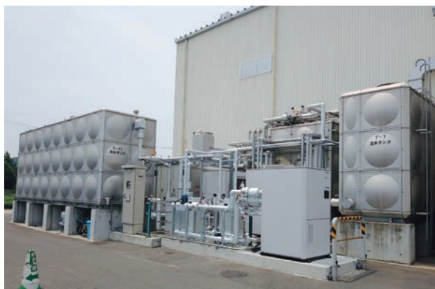
写真-2 冷温水供給設備外観(2019年)
