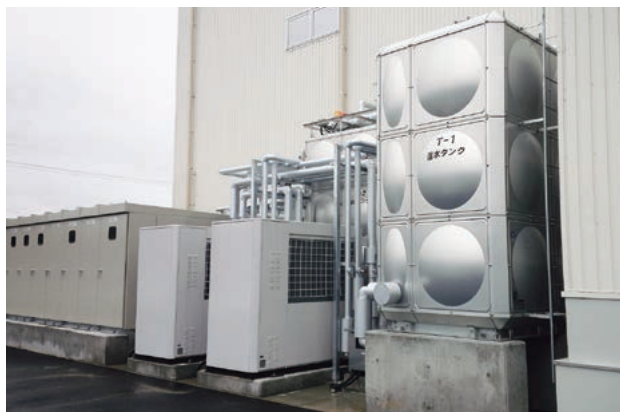
写真-1 冷温水供給設備外観(2015年)
