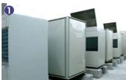
蓄熱槽室外機
